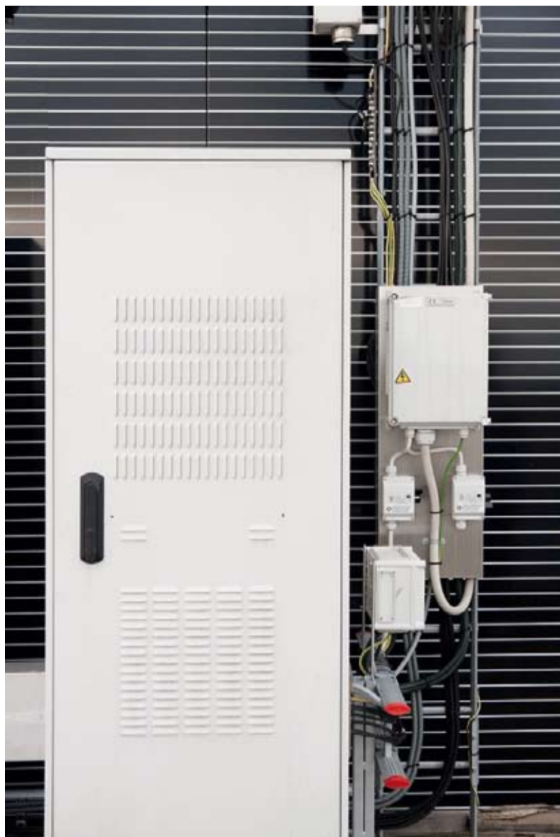
RBS'EN - Radio Base Stationen - omformer RF-signalet til digitale data, og et transmissionsmodul skaber forbindelsen til netværket. RBS'en er forbundet til en remote radio unit tæt ved antennen med et fiberkabel, der giver mindre signaltab.
